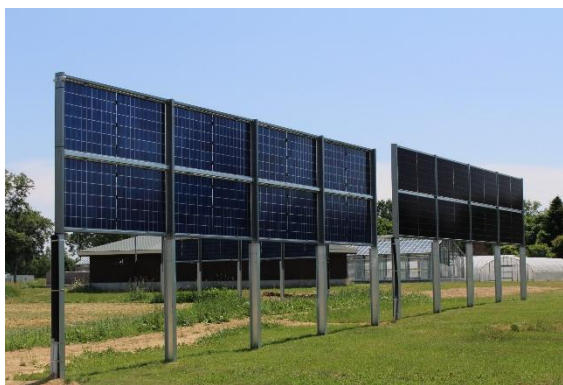
垂直式太陽光発電設備
