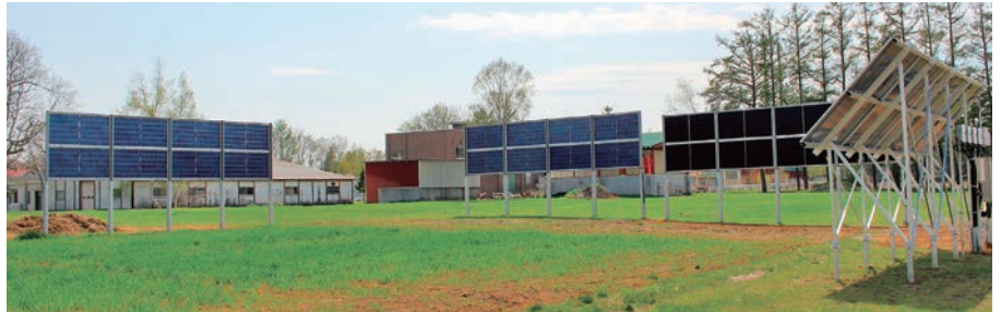
▲実習圃場に設置した太陽光発電設備
