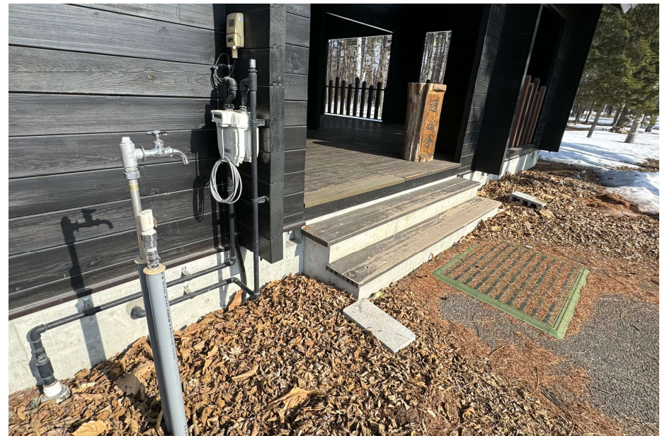
屋外給水設備
