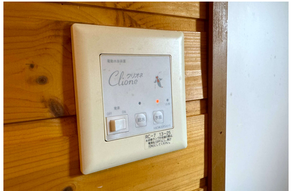
水抜き操作盤(給湯室内)
