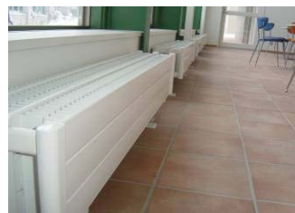
温水輻射式暖房による快適性向上
