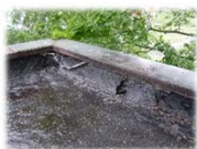
屋上防水の劣化状況 (合宿棟)
