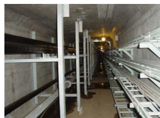
共同溝によるエネルギーの安定供給
