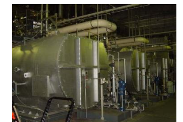
蒸気ボイラーの効率的活用を図る
