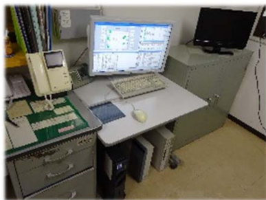
分散している防災監視盤・入退室設備
