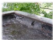
屋上防水の劣化状況 (合宿棟)
