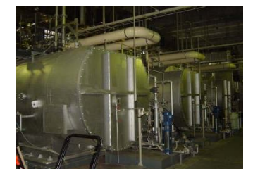
蒸気ボイラーの効率的活用を図る
