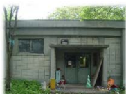
老朽劣化した外壁 (音楽演劇練習室)
