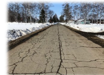
凍害による道路損傷
