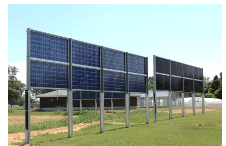
垂直式太陽光発電設備
