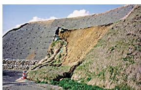
直しても直しても崩壊する寒冷地法面
