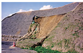
直しても なおしても 崩壊する 寒冷地法面
